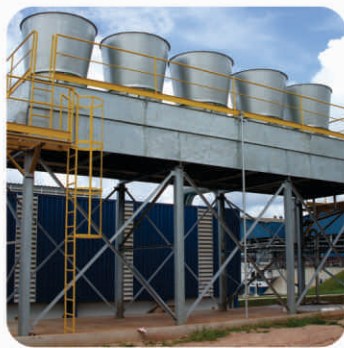
AEROCONDENSADOR (Aerocondensador / Air Cooled Condenser)
